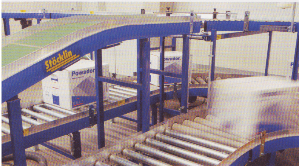
Rasante Kartonfahrt auf der Behälterfördertechnik im neuen Lager.
