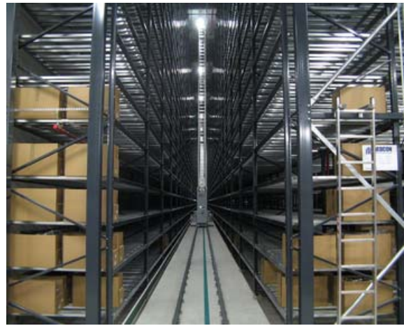
Bild 1: Reichlich Kapazität durch kompakte Lagerung im neuen doppel tiefen AKL
