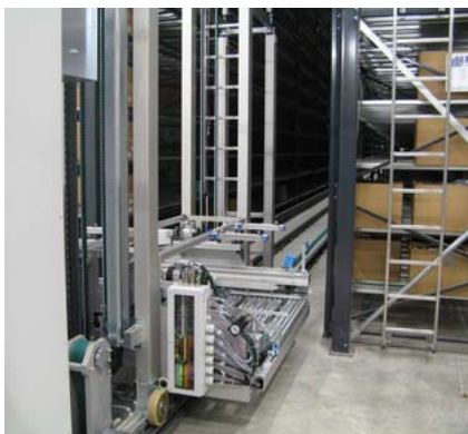
Bild 2: Je vier Kartonplätze auf den Regalbediengeräten sorgen für ansprechenden Durchsatz
